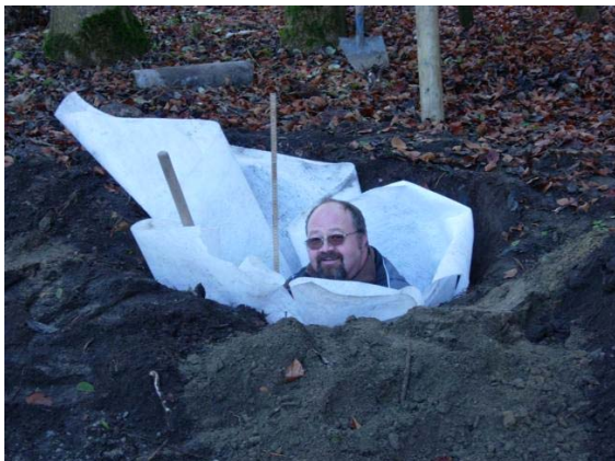
René nimmt es ganz genau bei der Kontrolle der Fundamente für die Schutzwand 90m ...
